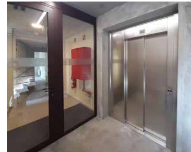
Wyckaert nam eveneens het luik technieken (ventilatie, sanitair, verwarming, elektriciteit, lift ...) voor zijn rekening.
